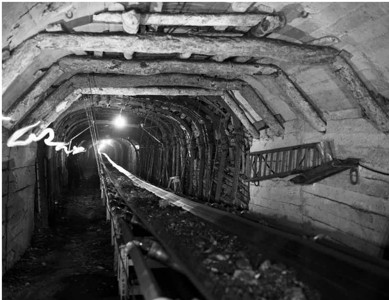
Combinació de quadres metàl·lics, fusta i volta de formigó del Pla Santa Isabel. (ARXIU COMARCAL DEL BERGUEDA, FONTS JOSEP DESEURAS, 040130520004245, 0010)
