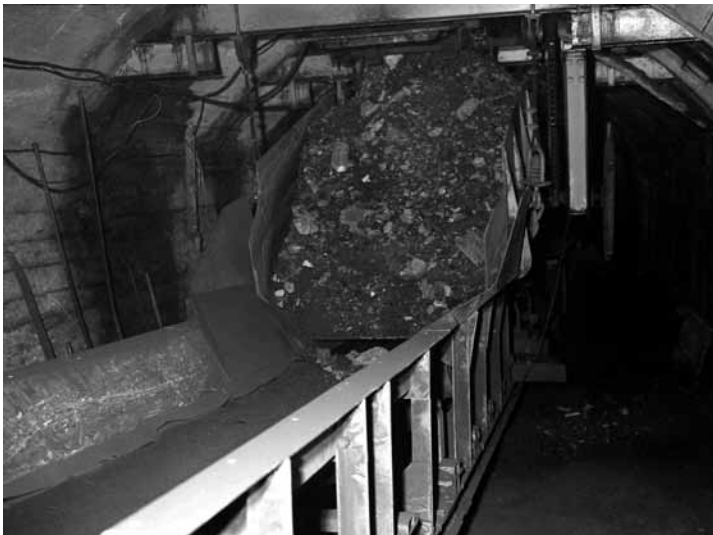
Detall de la tremuja del dipòsit de carbó del nivell 01 alimentant a la cinta Meco del pla inclinat Sta. Isabel.
